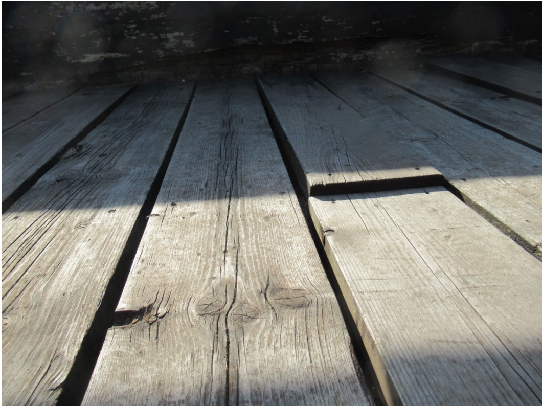
Dettaglio del dissesto del tavolato (Lato a valle)
