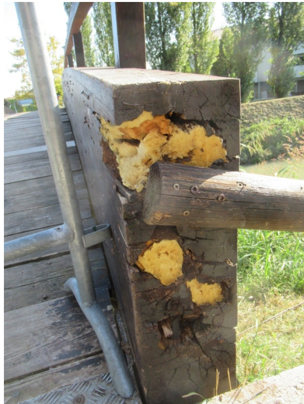
Dettaglio del collasso di uno degli appoggi della passerella esistente (Lato Fr. Maerne)
