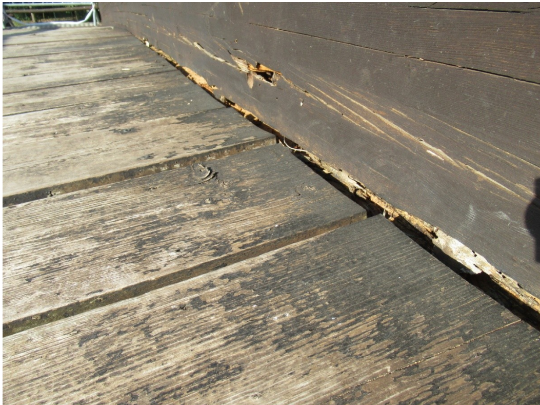
Dettaglio del dissesto della trave principale in mezzeria, che ha determinato la diminuzione della sezione
