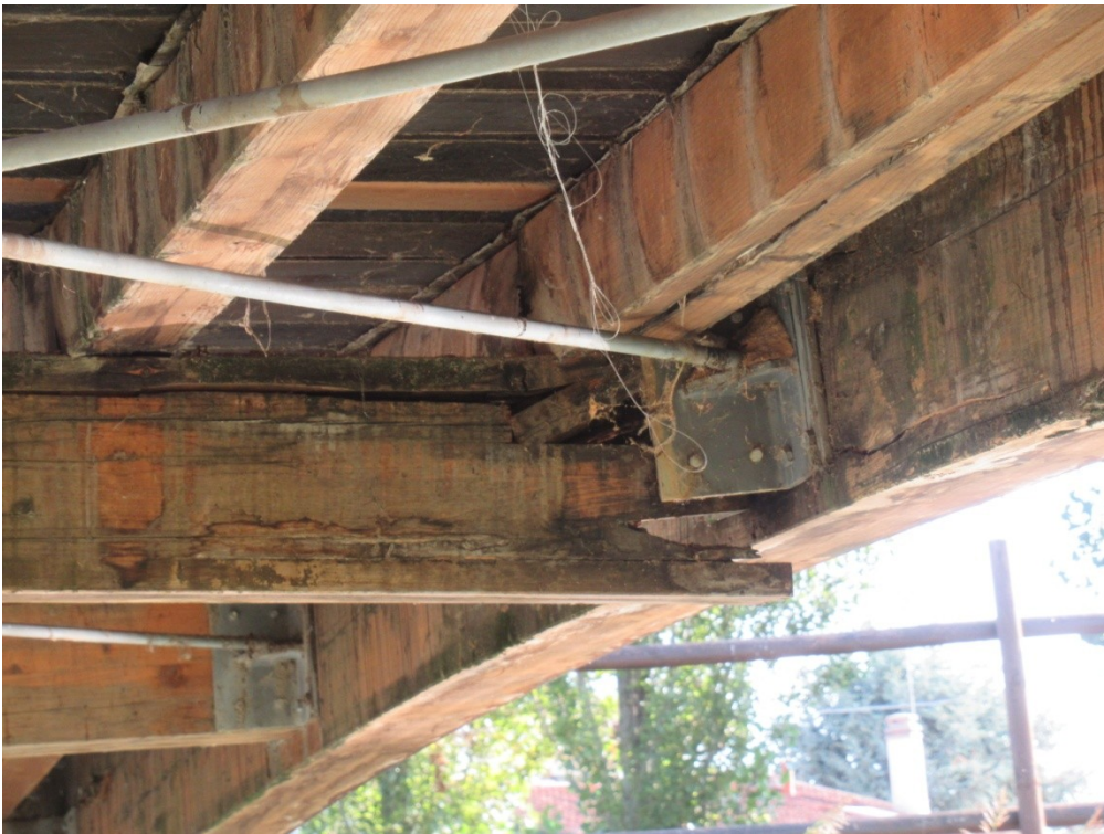
Dettaglio del dissesto della trave secondaria in corrispondenza del nodo con la trave principale, che ha determinato il collasso del giunto (Lato a valle)
