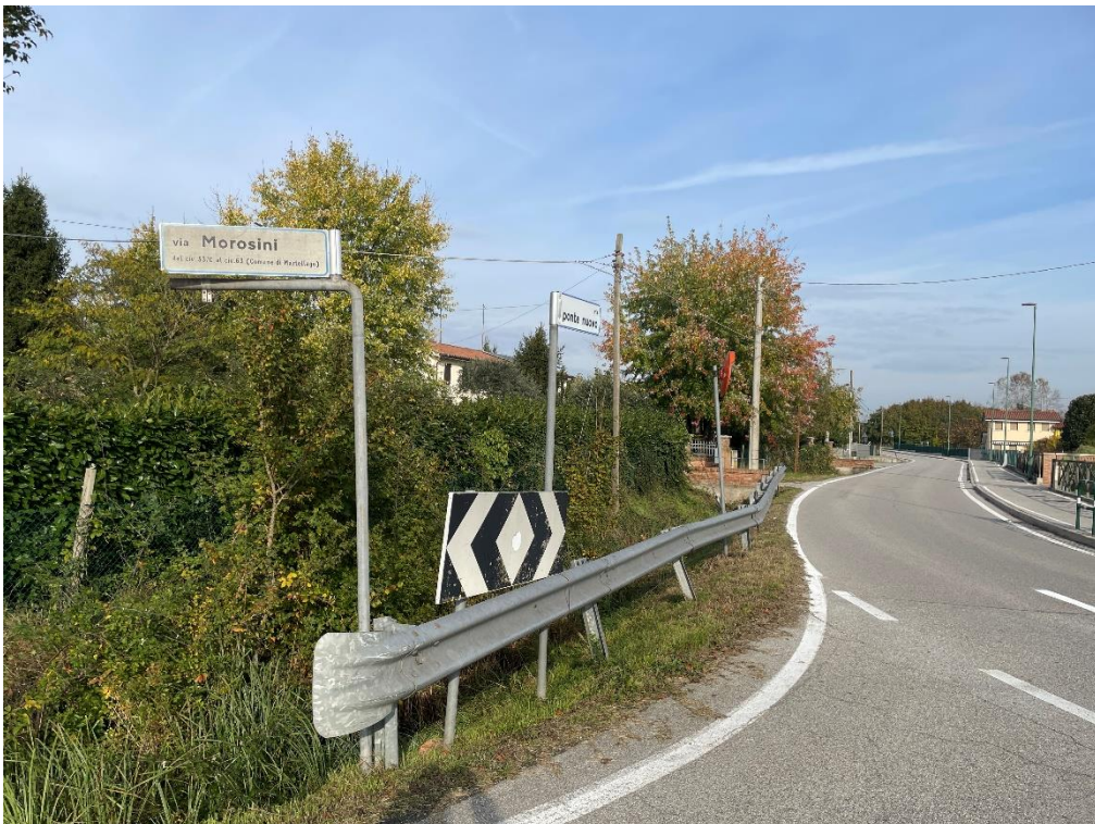
18 – incrocio via Ponte Nuovo, via Cà Lin, via Morosini: fosso da tombinare
